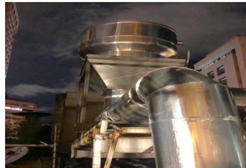
Fotografía 6. Ducto y sistema de extracción.
